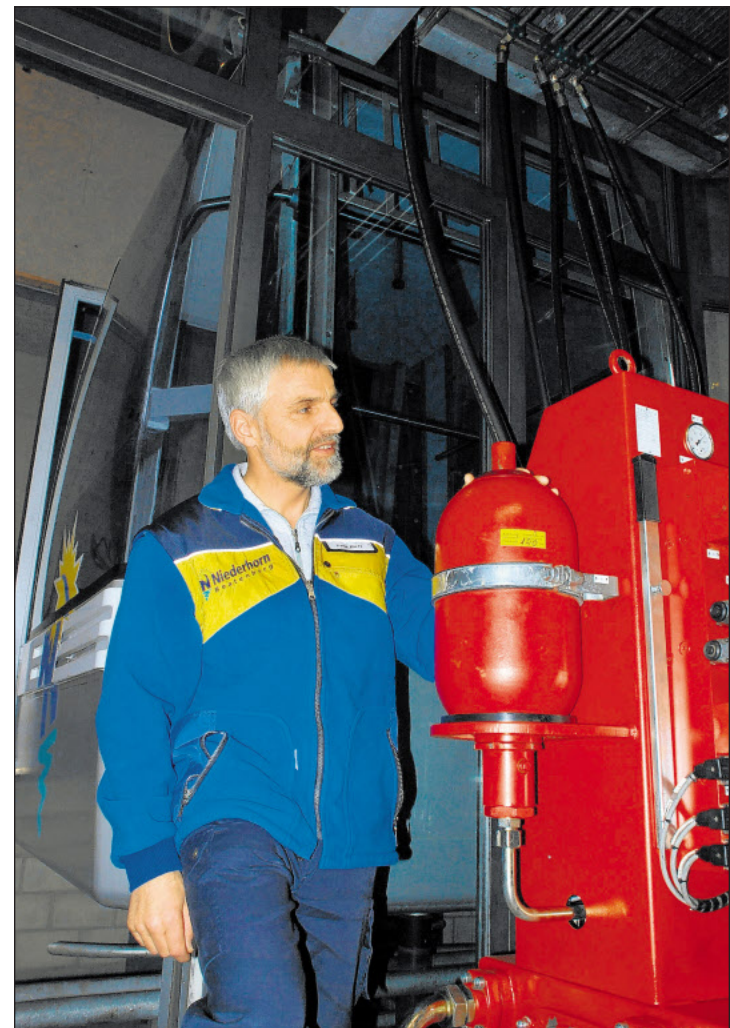
Die Gondel im Rücken und die Hydraulikmaschine im Blickfeld: Fritz Bieri, Technischer Leiter der Beatenberg-Niederhorn-Bahnen und der Drahtseilbahn Thunersee-Beatenberg.
